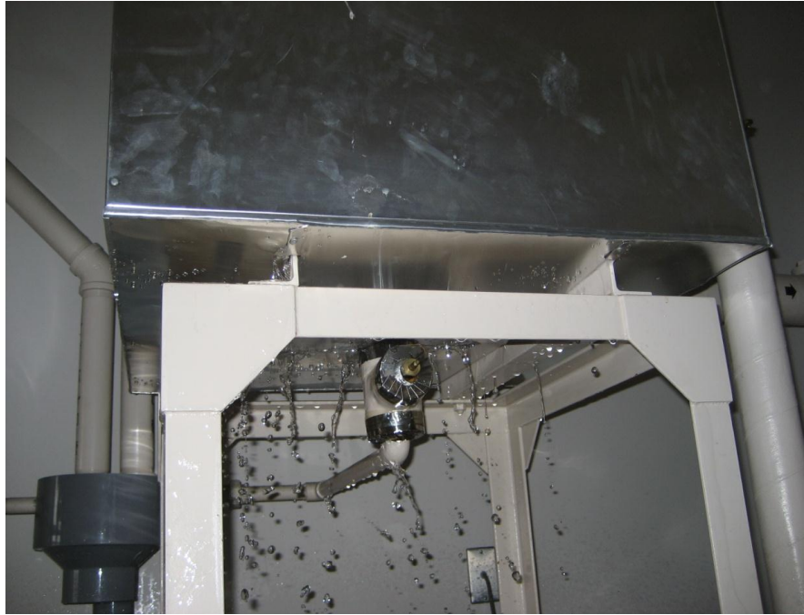
給水施設破損
