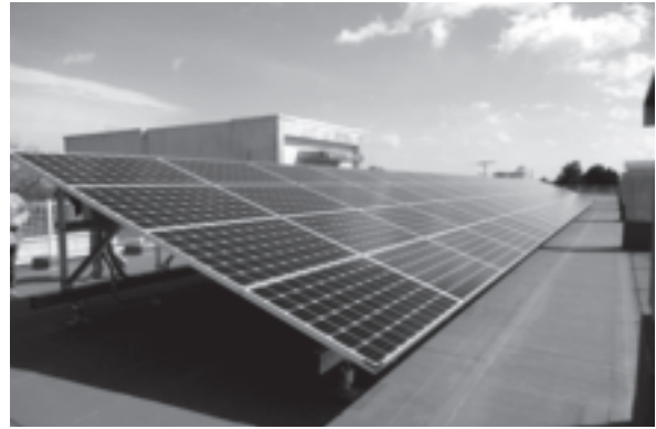
▲七ヶ浜町亦楽小学校に設置の太陽光発電設備
