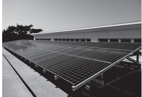
▲多賀城小学校に設置の太陽光発電設備
