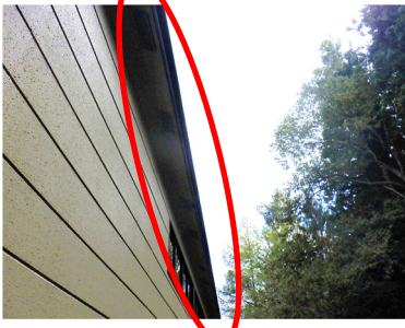
2-2 北側 軒天 換気口ずれ、軒天ボード穴
