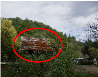
特記事項 炊飯棟 屋根錆
