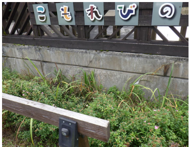
2-3 北側外部テラスコンクリート基礎 ひび割れ
