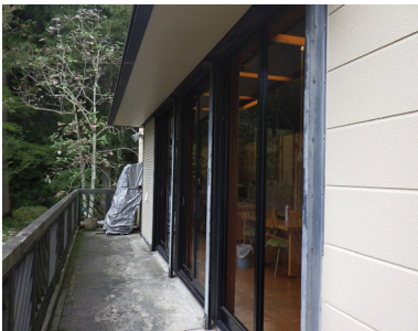
2-1 東側 冬季閉鎖用シャッター作動不良
