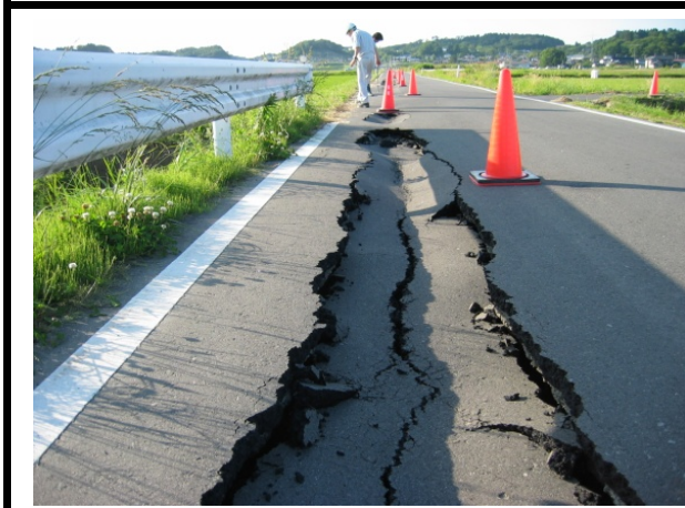
道路陥没状況
