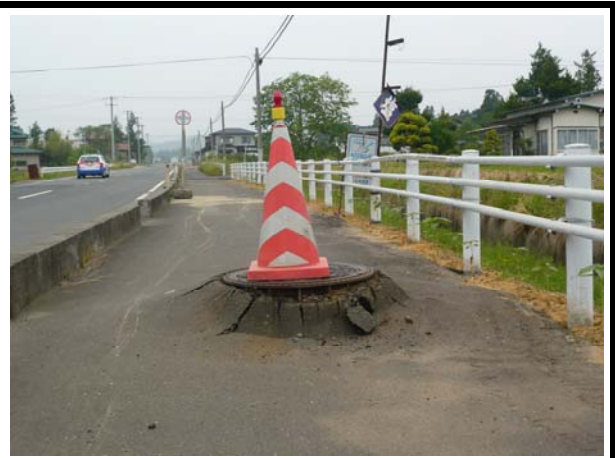
マンホール浮き上り状況
