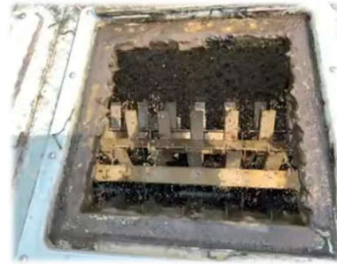
オキシデーションタッチ設備 (鹿島台浄化センター)
