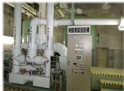
酸素発生装置（石巻東部浄化センター）
