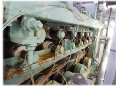
健全度2 汚泥脱水設備 (発錆は見られるが動作可)
