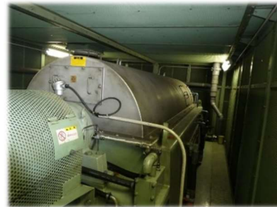
汚泥脱水設備（石巻浄化センター）
