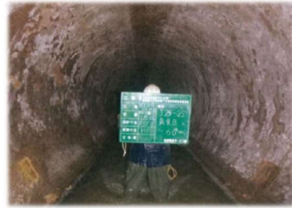
緊急度Ⅱ（中度）の管路
