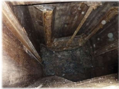
健全度1 ゲート設備 (開閉不可)
