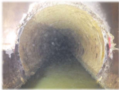
管路施設（阿武隈川幹線）
