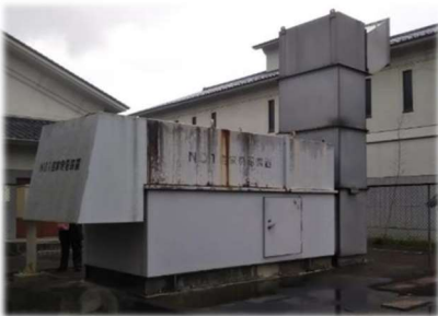
自家発電設備（大和浄化センター）
