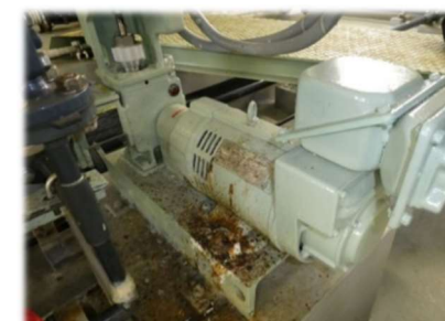
次亜ポンプ設備（石越浄化センター）
