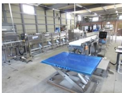
石巻魚市場に設置された連続個別非破壊放射能測定システム(簡易検査用)
