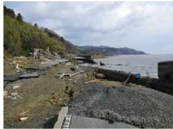
堤防の決壊と国道398号被災状況
