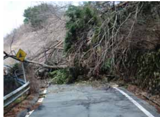
法面の崩壊(釜谷大須雄勝線)
