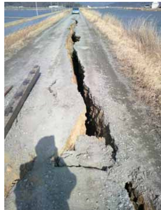
真野川堤防の亀裂
