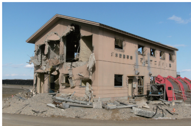
被災した花笠第2排水機場
