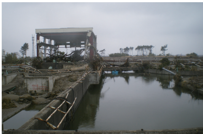
農業用施設被災状況（仙台市大堀排水機場）
