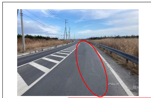
舗装にクラックが発生
