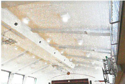
LED化した体育館の照明
