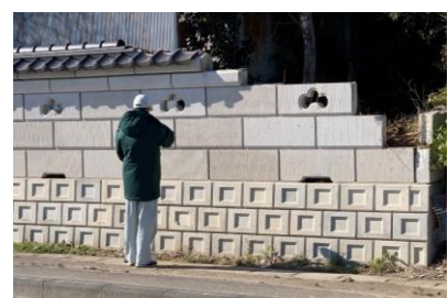
(3.13 被災 CB 緊急点検調査)
