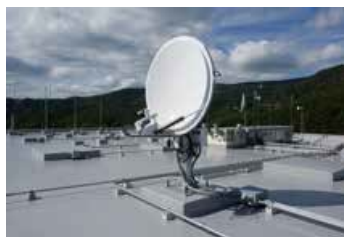
衛星回線用アンテナ
