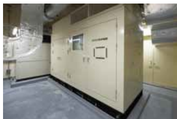
非常用自家発電機
