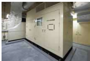
非常用自家発電機
