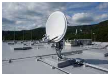
衛星回線用アンテナ
