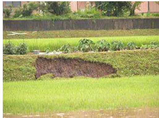
法面の崩壊状況
