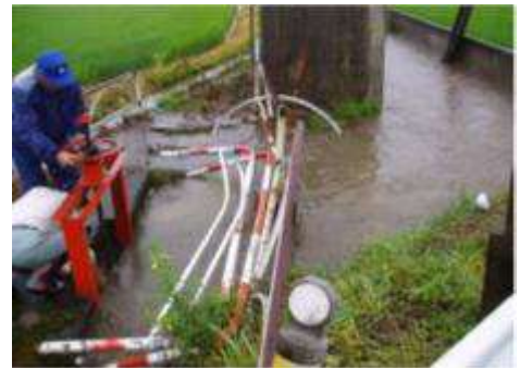
ゲートへのごみや流木の流入状況
