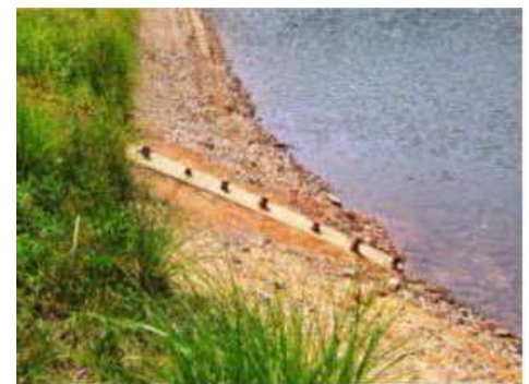
斜樋と取水栓
