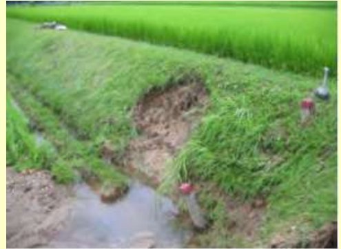
農用地法面が崩れた状況
