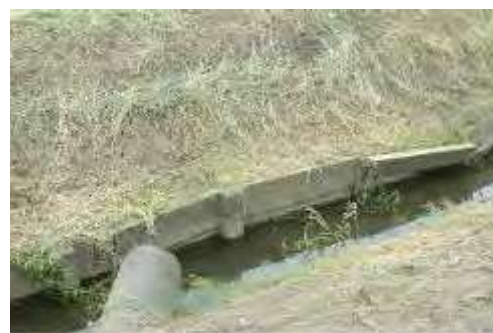
水路側壁のはらみの状況
