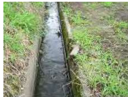
破損したU字溝
