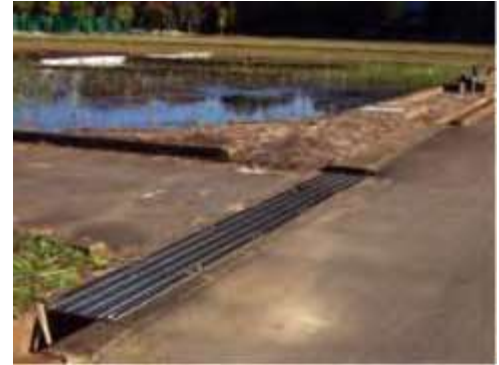
コンクリート蓋とグレーチング
