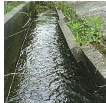
側壁の倒壊（側溝）
