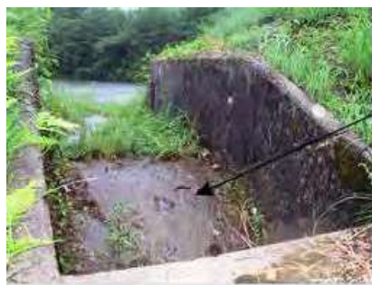
洪水吐底板（コンクリート）の欠損
