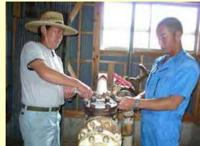
ポンプの点検状況
