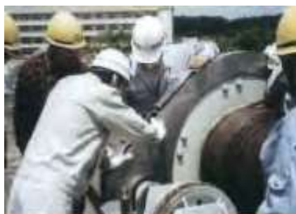
ポンプ点検状況
