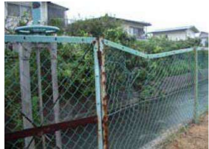
破損した金網フェンス
