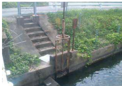
老朽化したゲート
