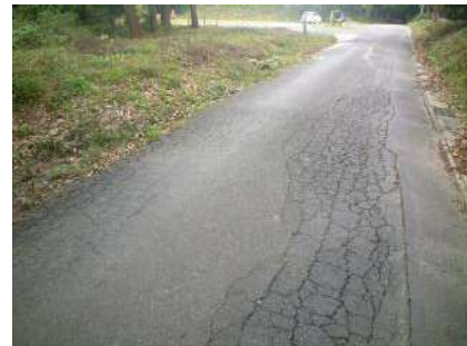
アスファルト舗装の老朽化
