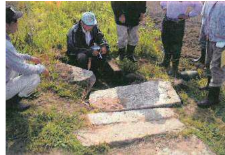
側溝蓋の損傷
