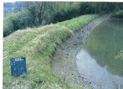
漏水が生じているため池
