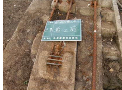
ため池における 老朽化したゲート
