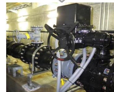
新設ポート付きバタフライ弁
