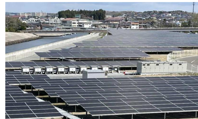
太陽光発電設備
