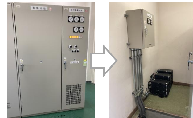
充電器盤＋蓄電池盤
