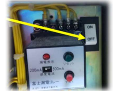
故障したスイッチ
