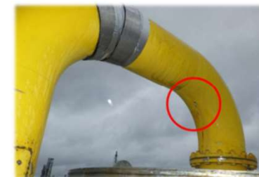
赤丸部に指先大の腐食孔
