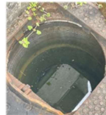
仕切弁MH内が冠水
