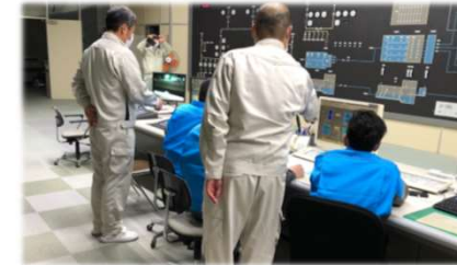
仙塩浄化センター
