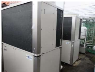
高効率空調機（室外機）
