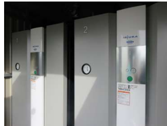
高効率ボイラ
