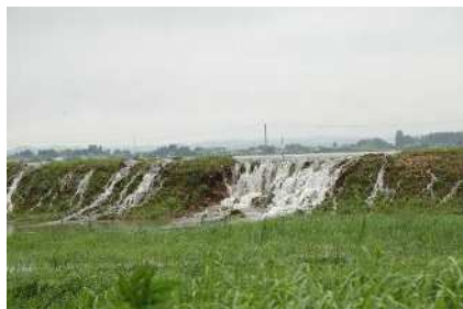
出来川左岸（渋江地先） 越水
