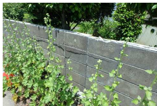
塀の剥離、はらみがないか
