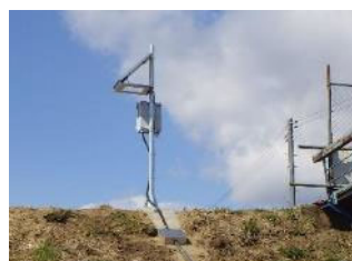
危機管理型水位計 (新川・村田町)
