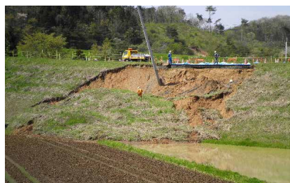
▲道路被災状況
