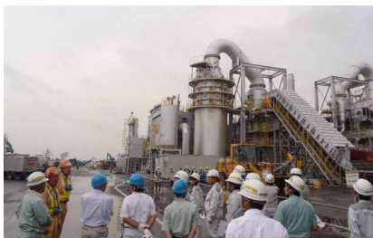
▲震災廃棄物処理施設(亘理処理区)
