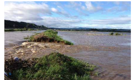
▲新川の堤防決壊(右岸)状況
