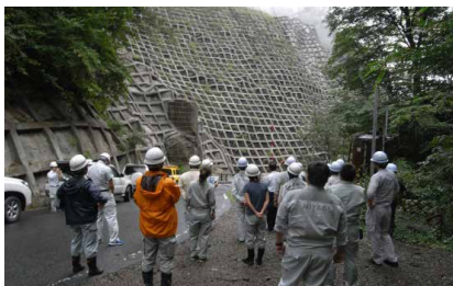
▲県道築館栗駒公園線の大規模法面崩壊箇所
