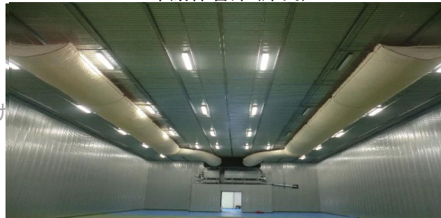
冷蔵保管庫(庫内)
