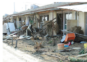
写真:津波被害を受けた市営立沼住宅(東松島市)
