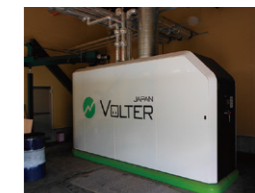
写真：小型木質バイオマスボイラー
