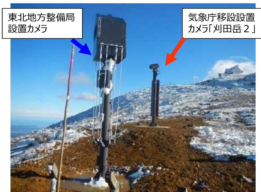
カメラ移設後設置状況
