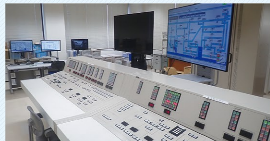
水管理システム(巨理・山元地区)
