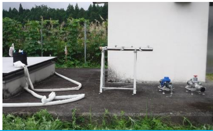
給水供給ユニット
