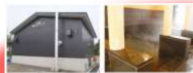
バイオマスボイラー (温泉施設)
