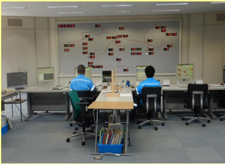
中央監視室における水処理監視状況
