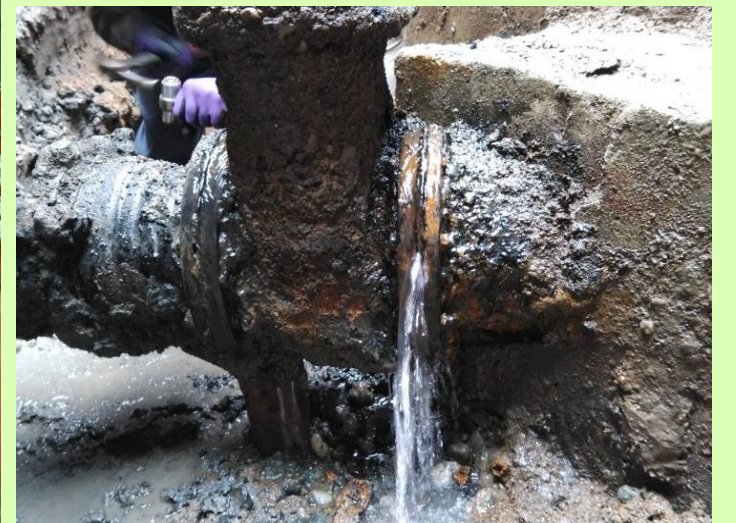
排泥弁からの漏水状況
