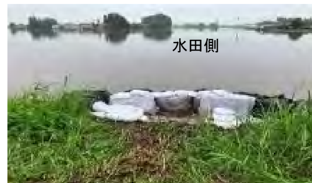
③ 0.3k右岸 漏水 月輪工法対策
