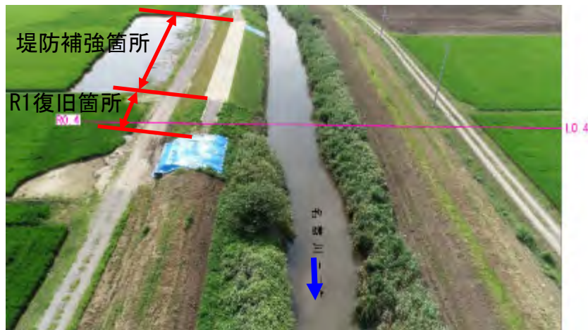
R1決壊箇所の状況(0.4k下流)
