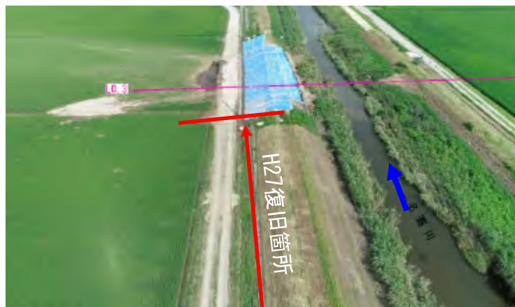
H27決壊箇所の状況(0.3k上流)
