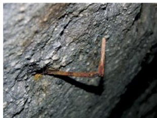
天井部で発見されたL字形の金具
