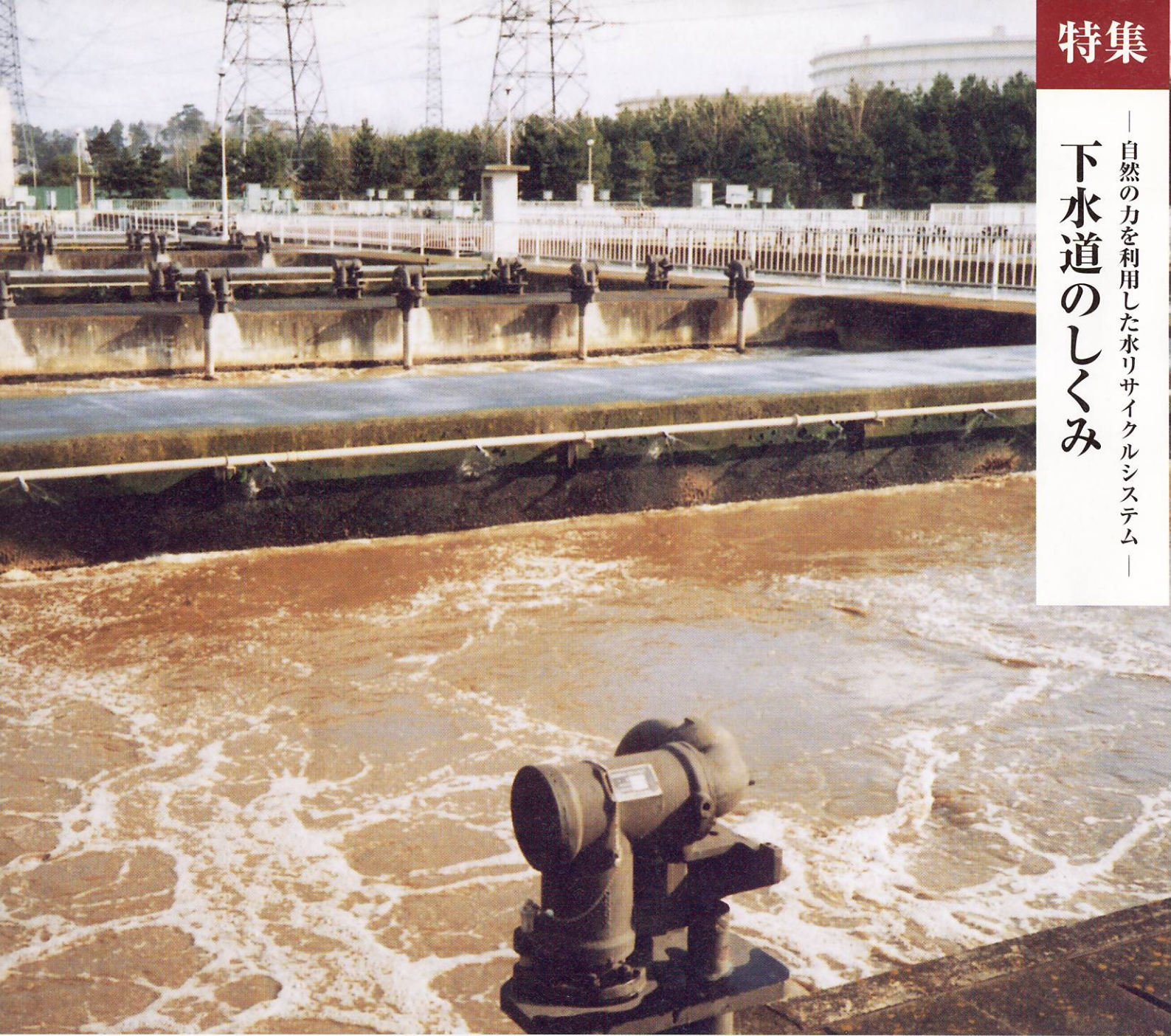
宮城県仙塩流域下水道 仙塩浄化センター 反応タンク
